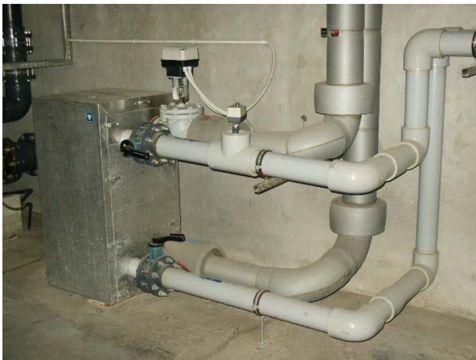
Wymiennik ciepła – podgrzew wody basenowej
